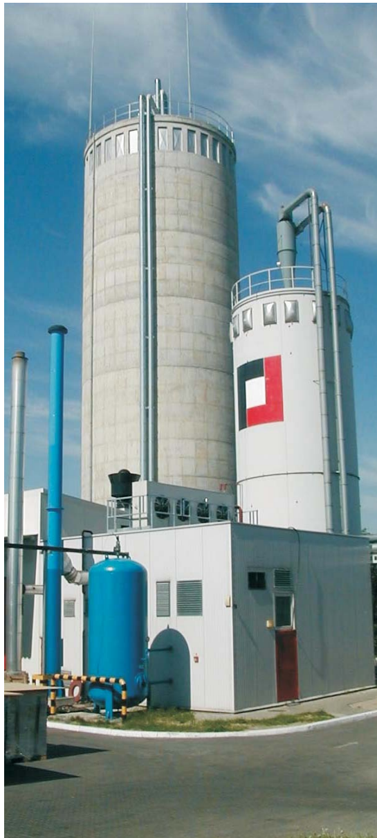
Котельная 1,0 MW с силосом для складирования топлива
